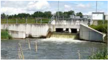
▲ Ausleitungsbauwerk mit technischer Fischaufstiegsanlage (links)
